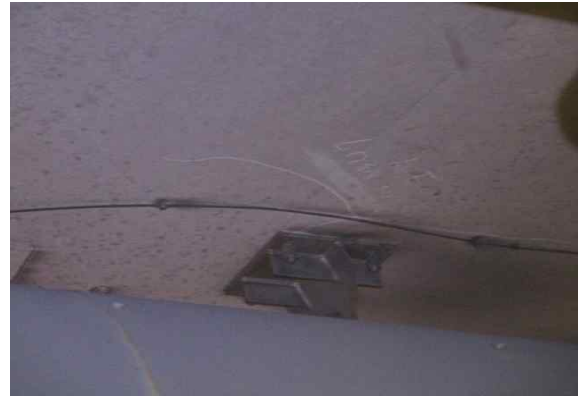
라이닝 SPAN.20 균열(0.3mm 미만)
