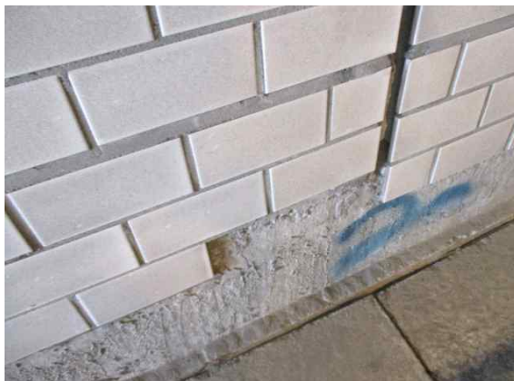
측벽부 SPAN.2 타일 탈락
