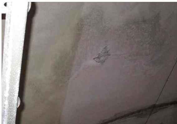
라이닝 SPAN.120 파손
