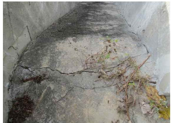
시점부 갯문 파손 및 이격
