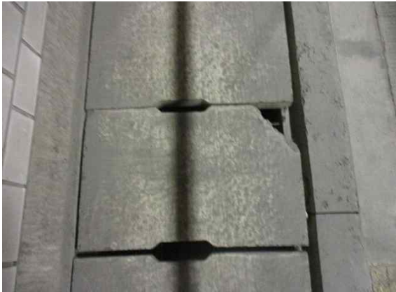
공동구 SPAN.23 덮개 파손
