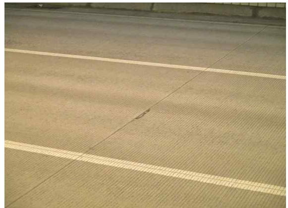
포장부 SPAN.129 파손
