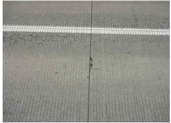
포장부 SPAN.25 파손
