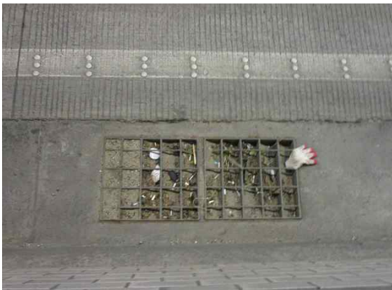
배수시설 SPAN.17 집수구 토사퇴적
