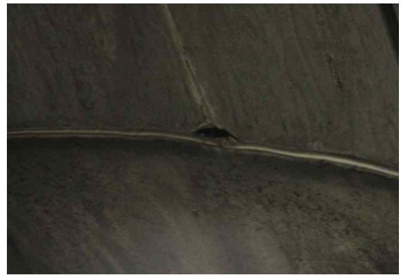
라이닝 SPAN.56 조인트부 파손
