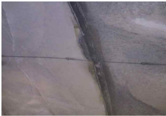
라이닝 SPAN.55 조인트부 들뜸
