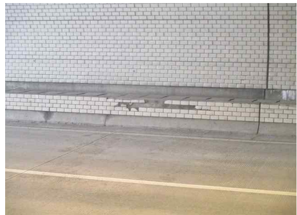
측벽부 SPAN.137 타일 탈락
