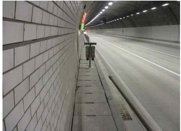
공동구 SPAN.51 난간 유실
