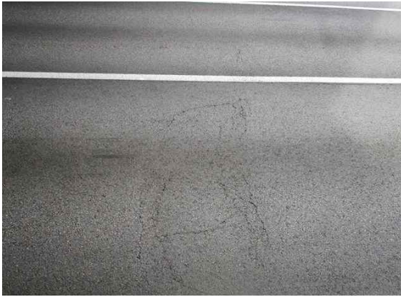
포장부 SPAN.1 접속부 아스콘 균열
