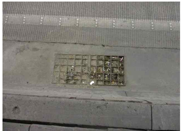
배수시설 SPAN.51 집수구 토사퇴적
