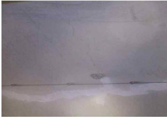
라이닝 SPAN.13 균열(0.3mm 이상)
